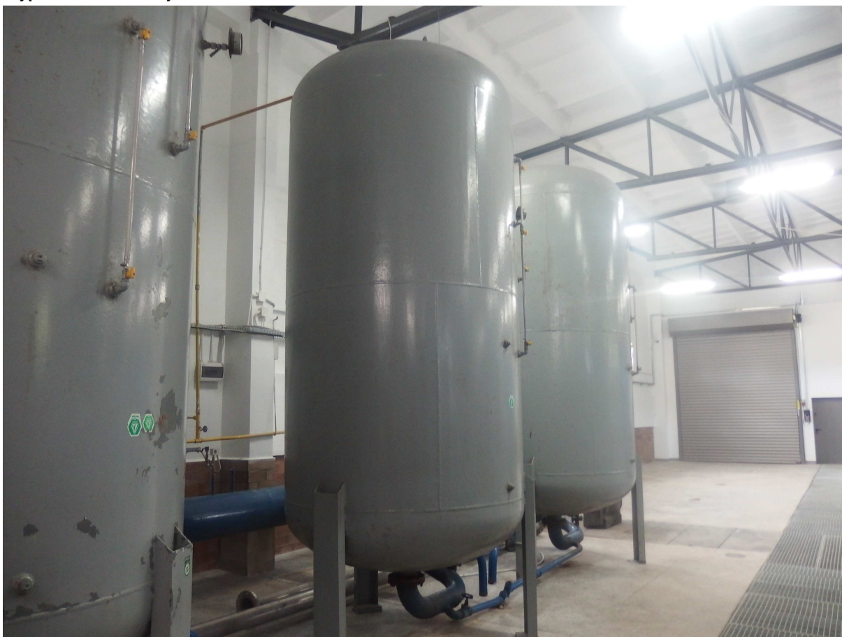
Zdjęcie 10. Zbiorniki hydroforowe na SUW Czersk
