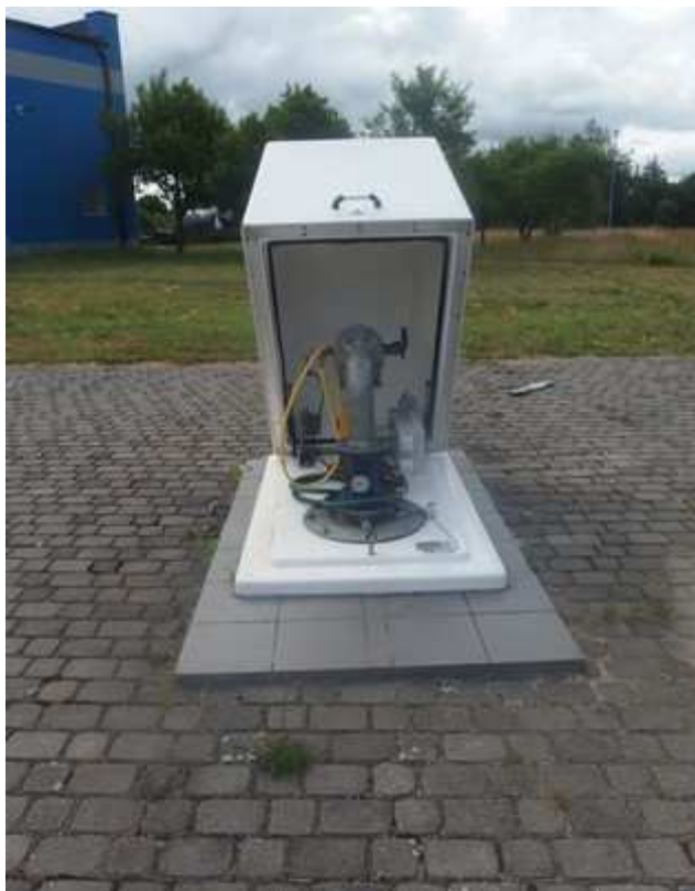
Zdjęcie 1. Ujęcie wody na SUW w Czersku (studnia 1)
