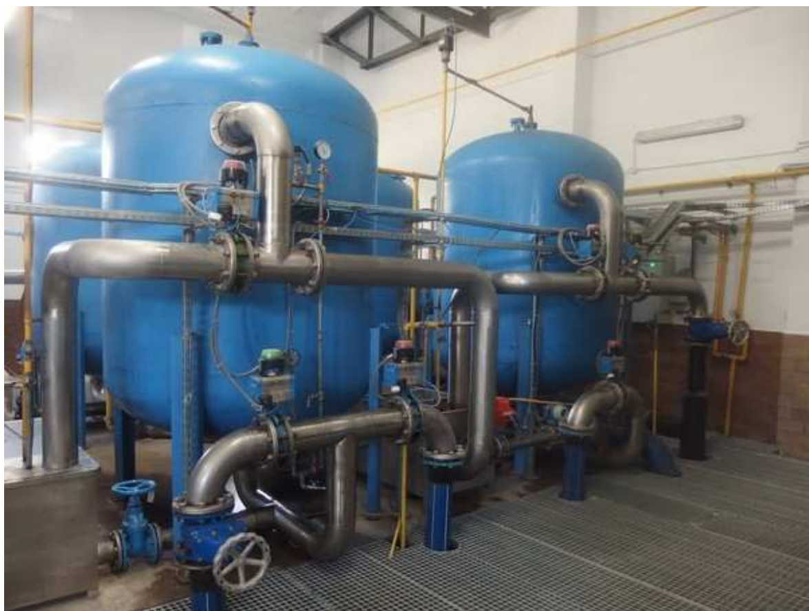
Zdjęcie 5. Układ filtracji na SUW w Czersku
