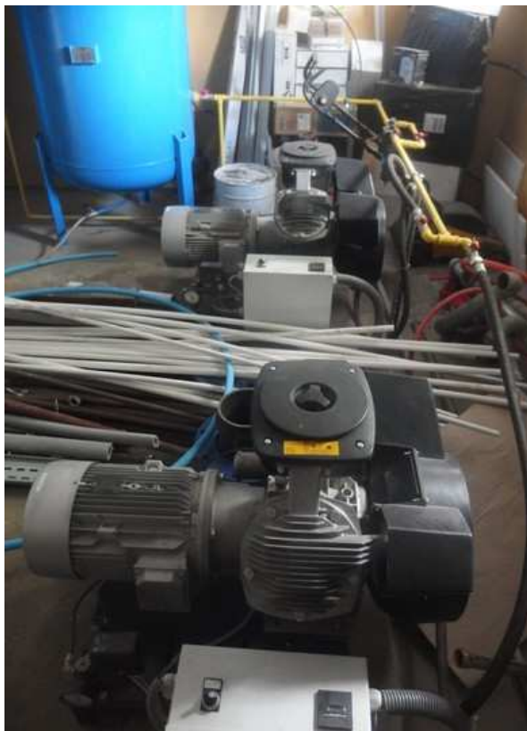
Zdjęcie 4. Sprężarki powietrza i zbiorniki akumulacyjne
